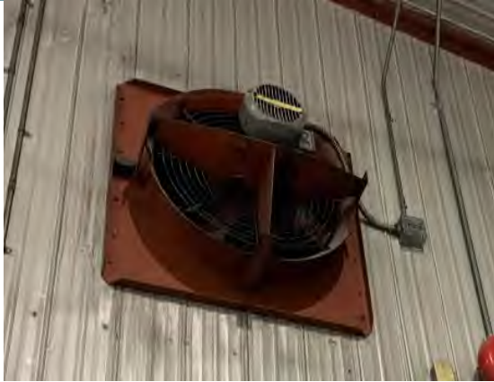
Photo 19 Ice Rink exhaust fan
